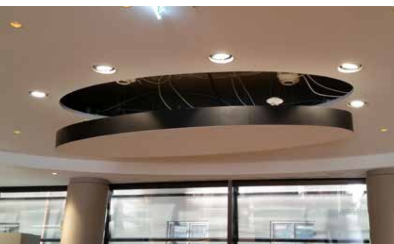
Absenkbare Deckenkonstruktion mit 3x PDI-50 in Gruppensteuerung
